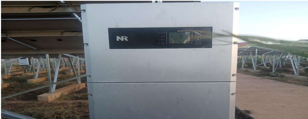
Fig. 15. NR-grid tide inverter rating 33kw
